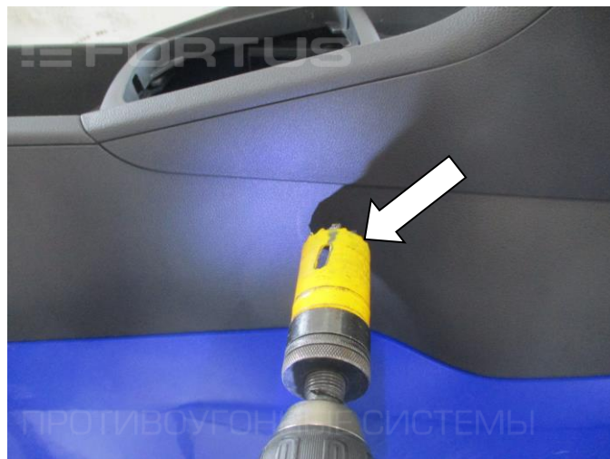
14. Разметьте и просверлите отверстие под корпус замка Ø32 мм
